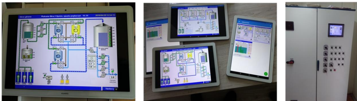
Monitoring urządzeń sterujących na SUW
